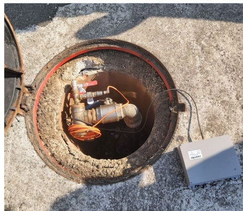
ISURLOG registrando presión de servicio en una red de distribución de agua potable
