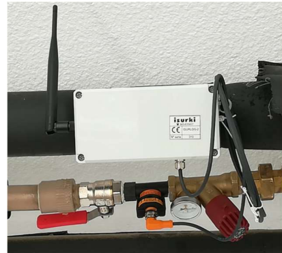
ISURLOG-LR registrando caudal y temperatura en una red ACS con enlace LoRa
