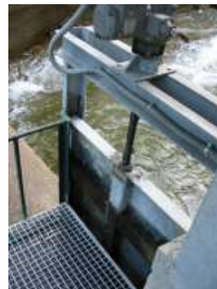
Control remoto inalámbrico de una compuerta de regulación de caudal través de WiFi o la nube.
