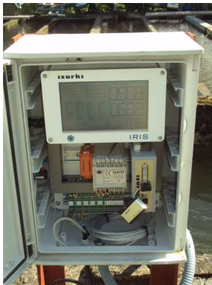
Ejecución en armario estanco para montaje a la intemperie (IP66) listo para conectar y funcionar.
